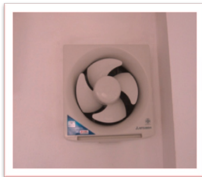
รูปที่ 5-2 อุปกรณ์ถ่ายเทอากาศภายในอาคารสถานที่ผลิต
